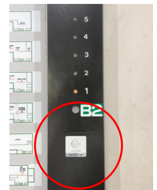
エレベータ 施工済ステッカー
